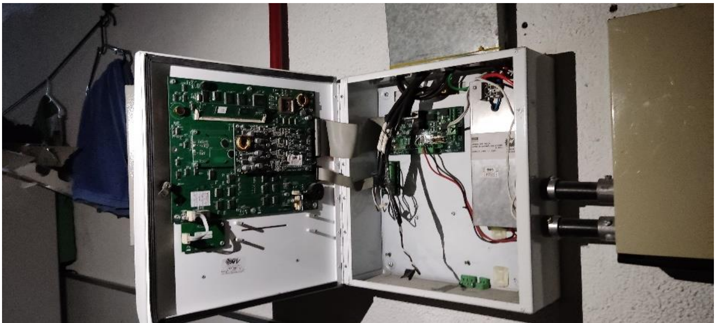
Painel Principal - Sala de Segurança no pavimento G-1 (Garagem 1)
